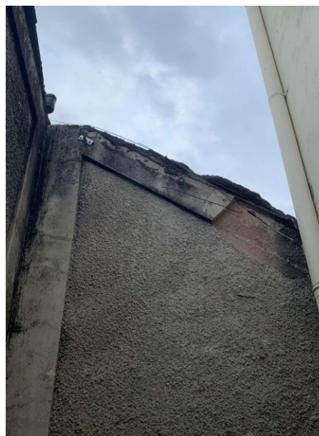
Foto 4 – ponto inclinado e sem cerca
