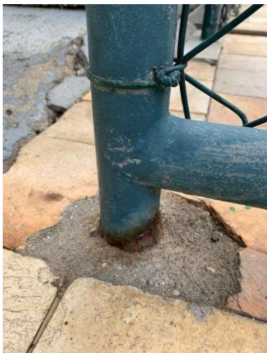
Foto 3 – pontos de enferrujamento
