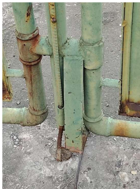
Foto 4 – pontos de enferrujamento
