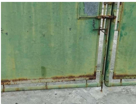
Foto 3 – pontos de enferrujamento
