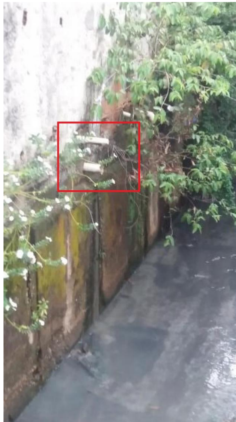
Figura 9 - Ligações clandestinas situadas no canal Peri-Peri
