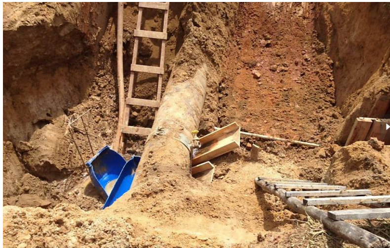
Figura1: Vazamento de nafta em duto da Transpetro.
