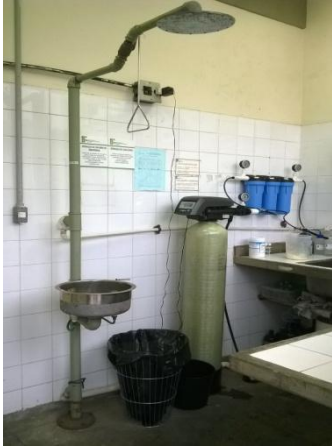
Figura 13: Chuveiro Lava-Olhos e Purificador de Água no LSR.
