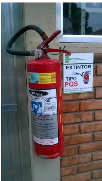
Figura 11: Extintor de Incêndio de Pó Químico Seco (PQS) encontrado no lado externo ao LSR.
