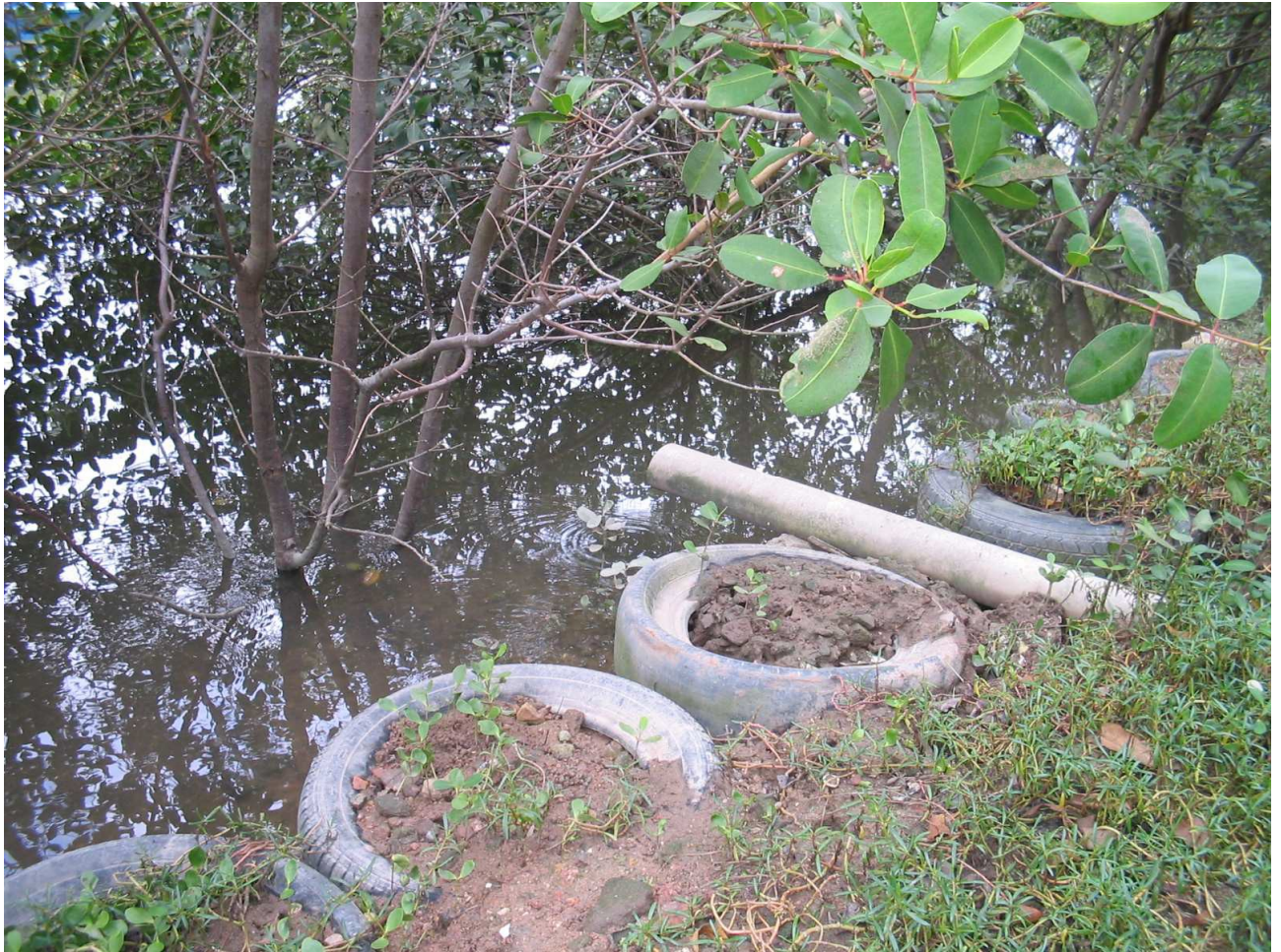
Figura 4.2: Muro de pneus e ligação clandestina de esgoto. Fonte: foto cedida por José Luiz de Castro Ferreira.
