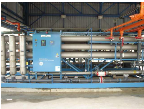
Figura 7. Módulos de osmose inversa (SIXEL, 2009).
