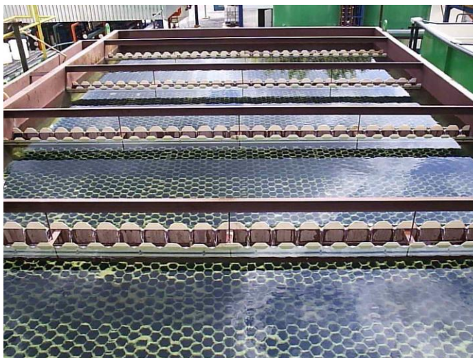
Figura 3. Tanques de decantação lamelar (SIXEL, 2009).
